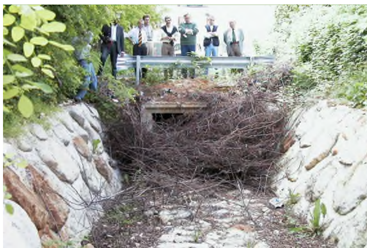
Figura 2: esempio di ostruzione del reticolo di drenaggio indotto dallo scarico di materiale di sfalcio in alveo (T. cannone, Bovezzo, BS)
